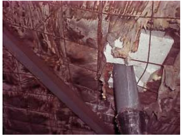
Рис. 4. Дефекти і пошкодження утеплювача і склоткани: а) - місцна погибь раскоса ферми; б) поверхню корозія елементів ферм.
