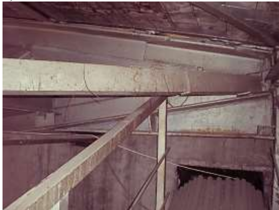
Рис. 3. Дефекти і пошкодження металічних ферм: а) - місцна прогибь раскоса ферми; б) поверхню корозія елементів ферм.
