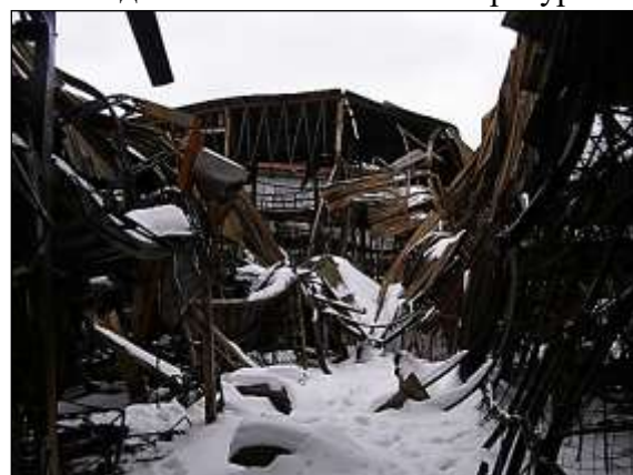
Рис. 2. Состояние кровли здания после воздействия высокой температуры
