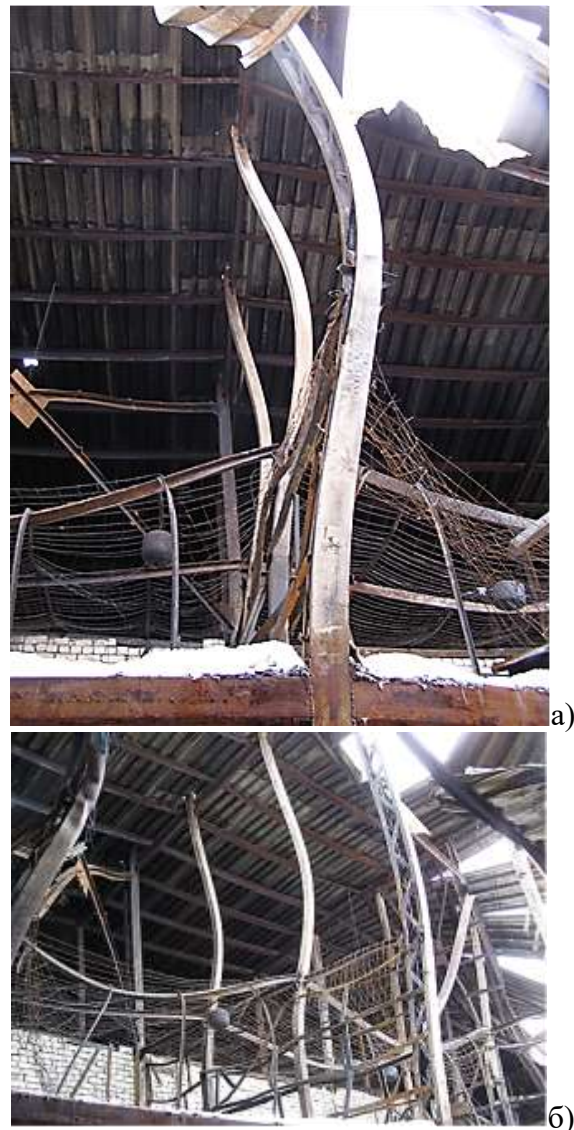
Рис. 1. Деформации конструкций после воздействия высоких температур
