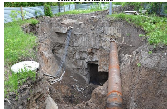
Рис. 2. Последствия разрушения штольни, выполненной горным способом.
