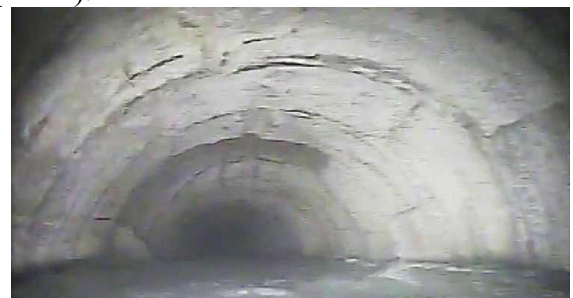
Рис. 1. Разрушение несущей обделки канализационного тоннеля.
