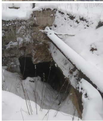
Рис. 8. Первинна стадія просідання ґрунту в зоні пошкодження тунелю
