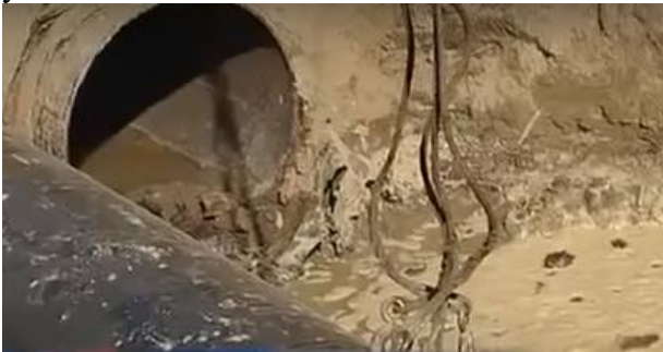
Рис. 2 Аварии канализационных трубопроводов
