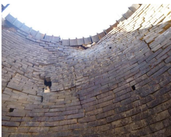
Рис. 5. Выпучивание (потеря устойчивости) кладки футеровки дымовой трубы.
