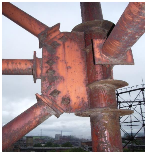
Рис. 7. Коррозионный износ элементов несущей башни до 10%.
