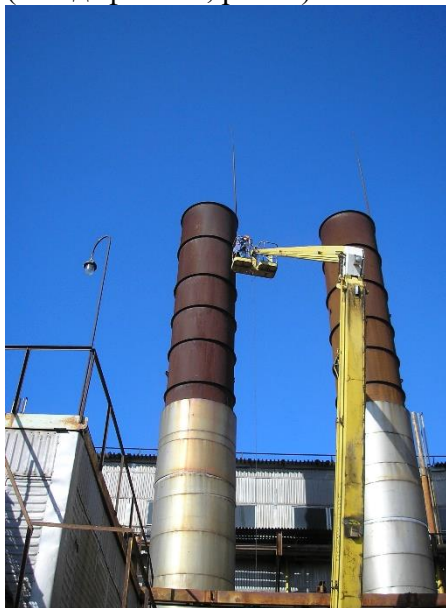
Рис. 3. Определение коррозионного износа дымовой трубы.
