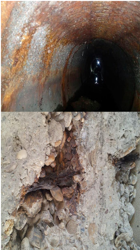
Рис. 6. Газова корозія бетону, втрата в'язучих властивостей цементного каменю: утворення гіпсу у цементному камені бетону з сульфатним середовищем каналізаційної мережі веде до руйнації бетону.
