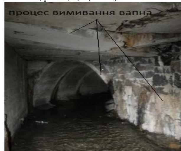
Рис. 2. Колектор, де руйнування бетону у плитах та розчину у швах кладки з бутового каменю відбувається в результаті вилуговування (позначено стрілками).
