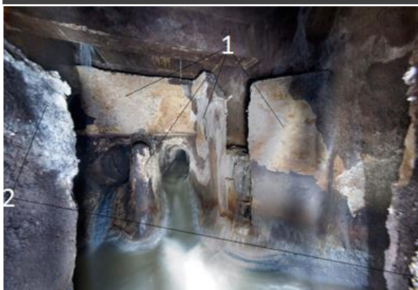
Рис. 8. Руїнування бетонного трубопроводу при сульфатній корозії:
