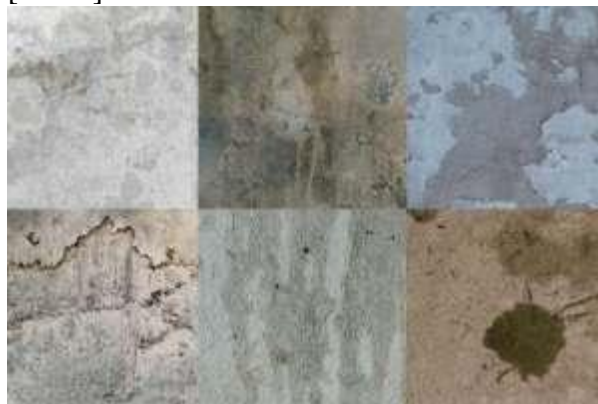
Рис. 5. Сульфатна корозія бетону
