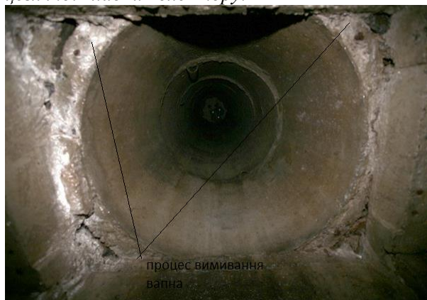
Рис. 4. Руйнування бетонної труби колектору у результаті вимивання вапна із тіла бетону.
