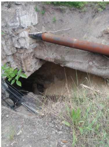
Рис. 5. Провал грунта по ул. Северина Потюцкого в результате разрушения железобетонного канализационного тоннеля D=1800 мм (подмыв грунта под камерой гашения), 2018 г.
