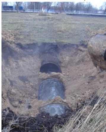
Рис. 1. Сквозной обвал грунта в результате разрушения сводовой части канализационного тоннеля к Безлюдовским очистным сооружениям.
