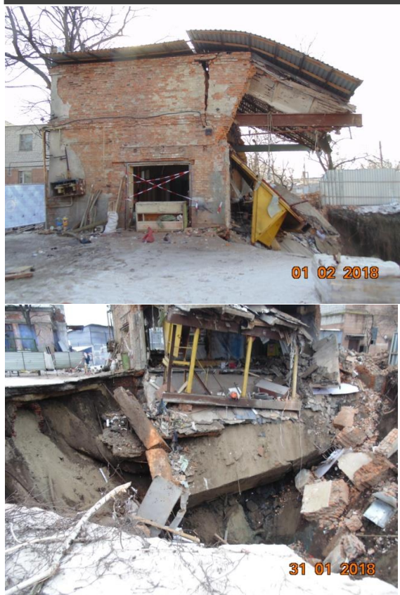
Рис. 7. Обрушение прилегающего здания в результате повреждения канализационного тоннеля
