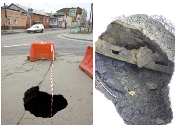
Рис. 3. Обвал грунта в результате разрушения канализационного коллектора в районе центральной части г. Харькова по ул. Большая Панасовская.
