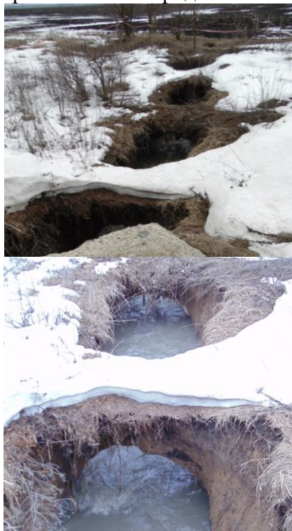
Рис. 2. Разрушение канализационного тоннеля в районе ХТЗ в результате воздействия биогенной коррозии.
