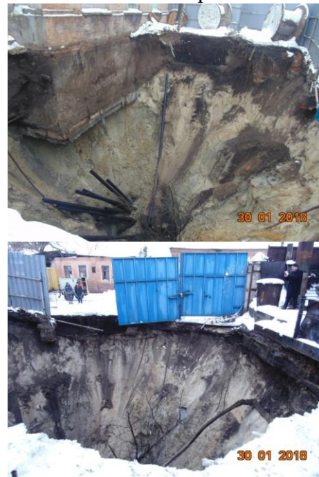
Рис. 6. Аварийное повреждение канализационного тоннеля по ул. Грековской, 2018 г.
