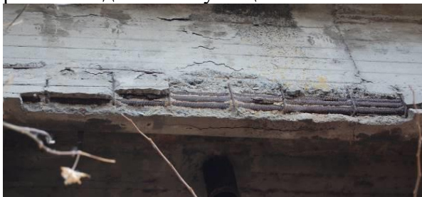
Рис. 1. Руйнування захисного шару бетону в балці прольотної будови моста через р. Мжа на під'їзді до м. Зміїв
