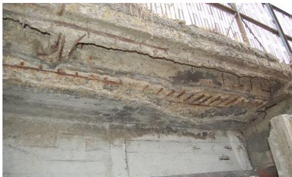
Рис. 2. Руйнування захисного шару в консолі балки моста через р. Мжа на під'їзді до м. Зміїв
