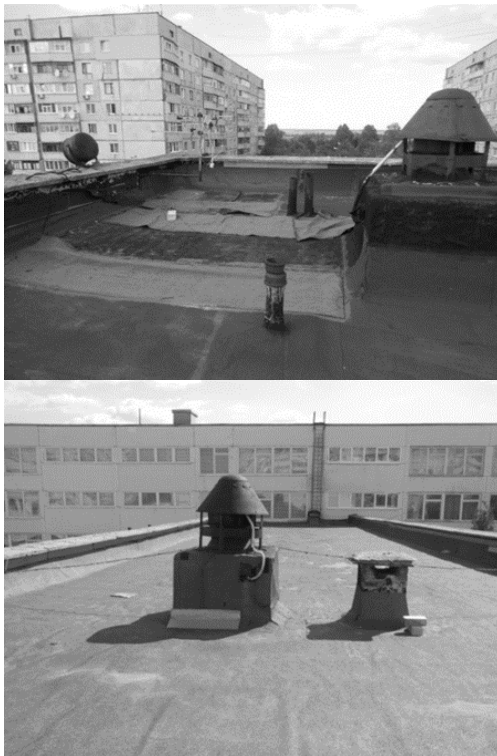
Рис. 4. Покрівля потребує утеплення
