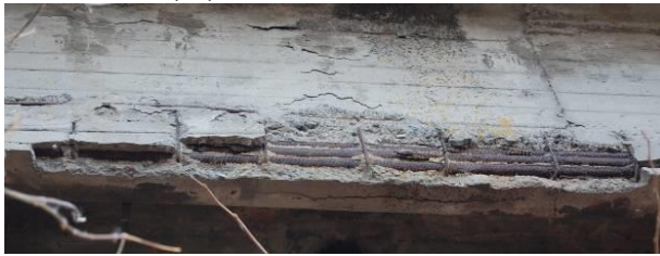
Рис. 1. Руйнування захисного шару бетону в балці прольотної будови моста через р. Мжа на під'їзді до м. Зміїв
