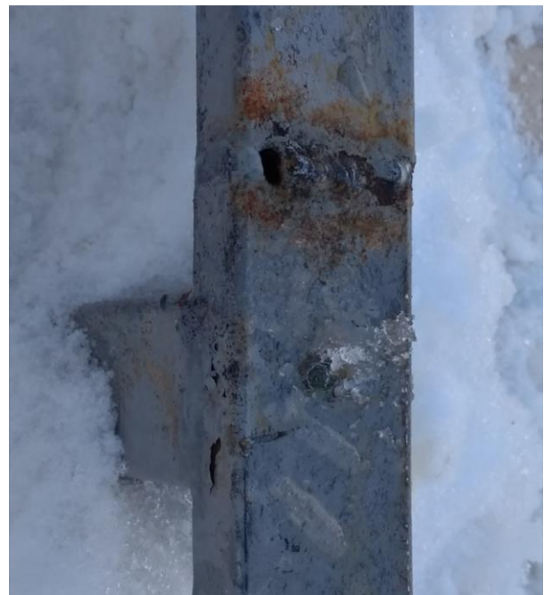
Рис. 6. Дефекты сварных соединений
