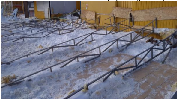
Рис. 1. Общий вид обрушившихся конструкций
