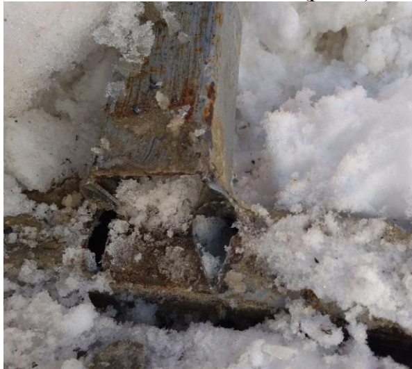
Рис. 3. Конструкция стойки после обрушения
