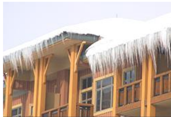
Рис. 1. Обледенение кровли одноэтажного жилого дома
