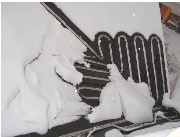
Рис. 4. Таяние наледи и снега на кровле при включенной системе антиобледенения
