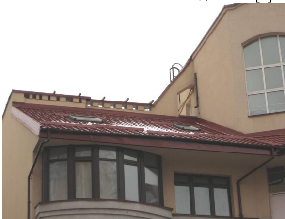
Рис. 5. Общий вид кровли здания, оборудованной системой кабельного антиобледенения
