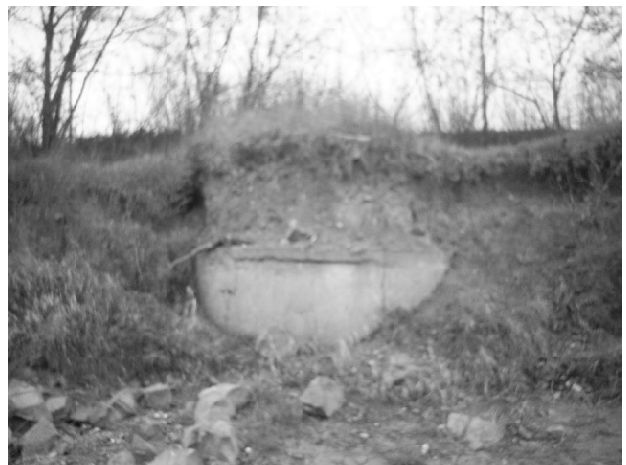
Рис.2. Стан залізобетонних конструкцій оглядового колодезя водозабору
