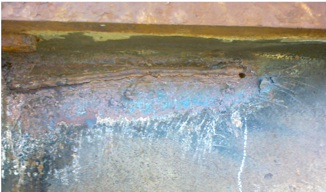
Фото 5 - Тріщина в вертикальній стінці біля її зварювання з верхнім поясом кінцевої балки
