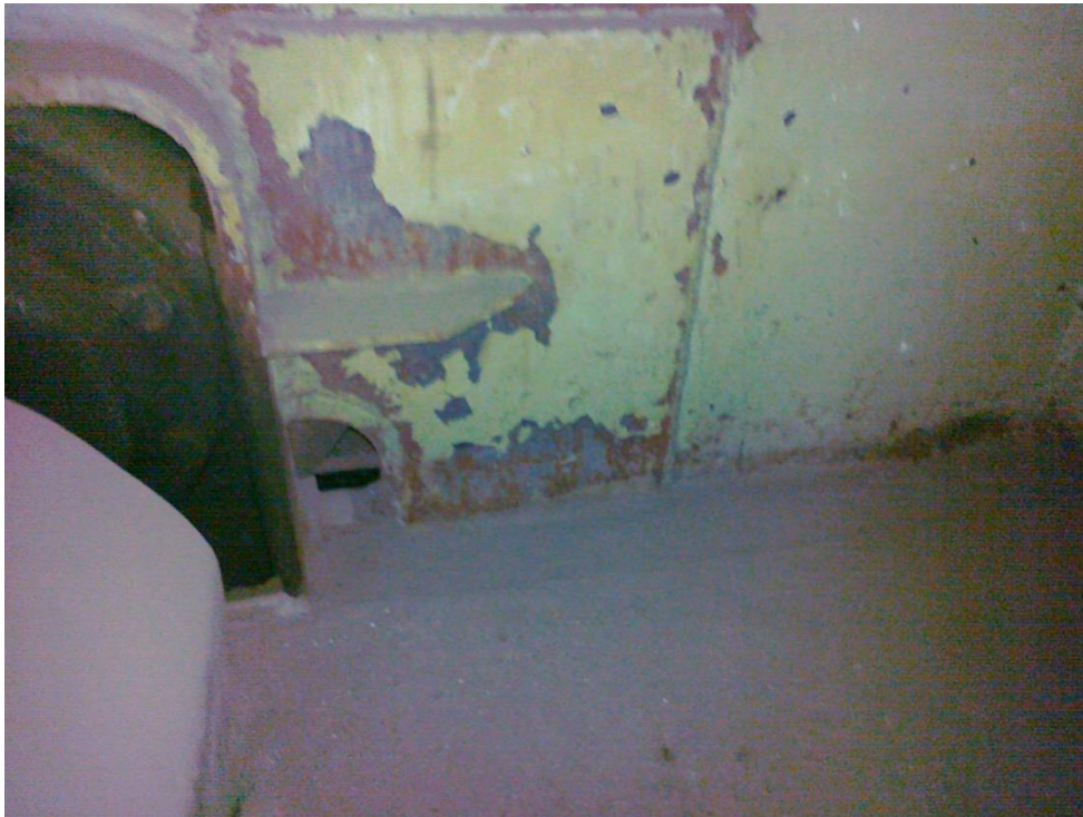
Фото 1 - Буксовий вузол кінцевої балки крану з накладкою підсилення
