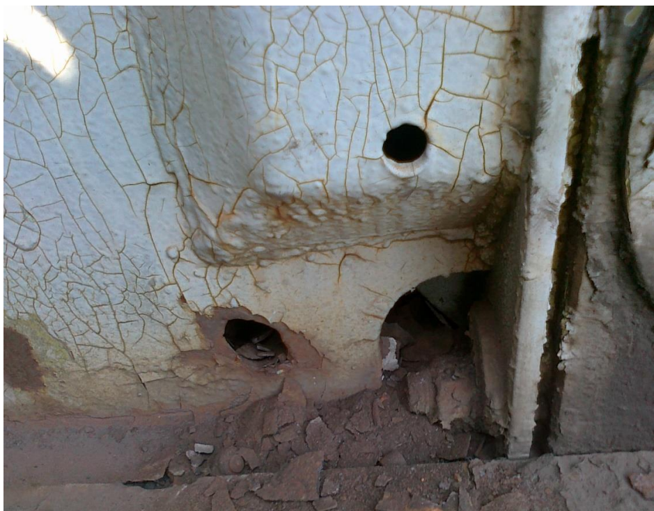
Фото 2 - Корозійне руйнування вертикальної стінки кінцевої балки
