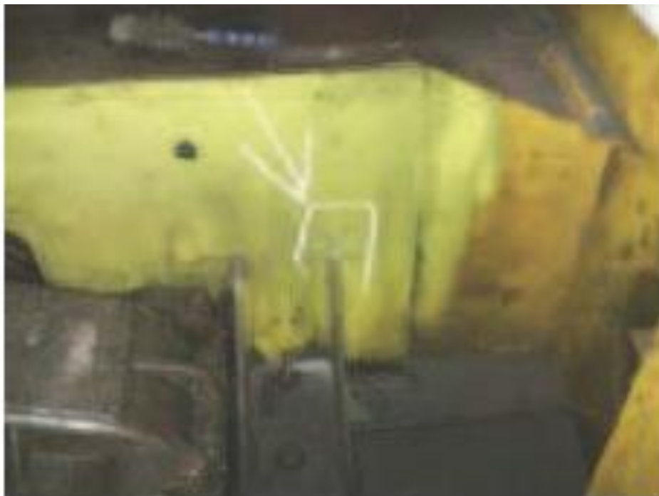
Фото 9 - Тріщина в зоні зварювання кронштейна кріплення механізму пересування до вертикальної стінки кінцевої балки [2]
