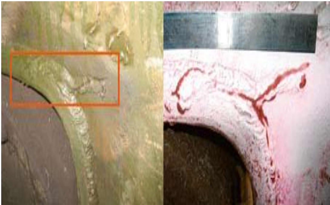
Фото 4 - Тріщина у вертикальній стінці буксового вузла кінцевої балки [2]
