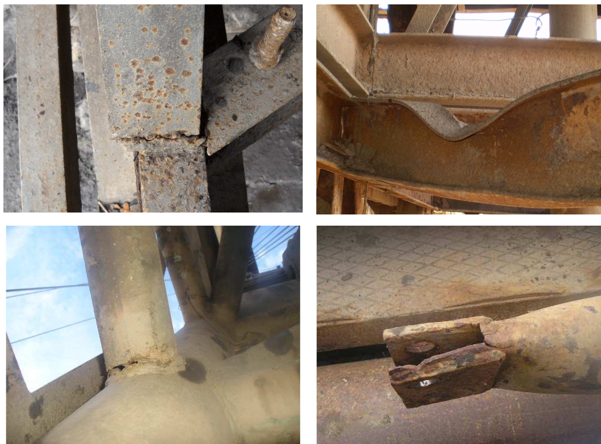
Рисунок 5 – Характерні дефекти металоконструкцій бурових веж
