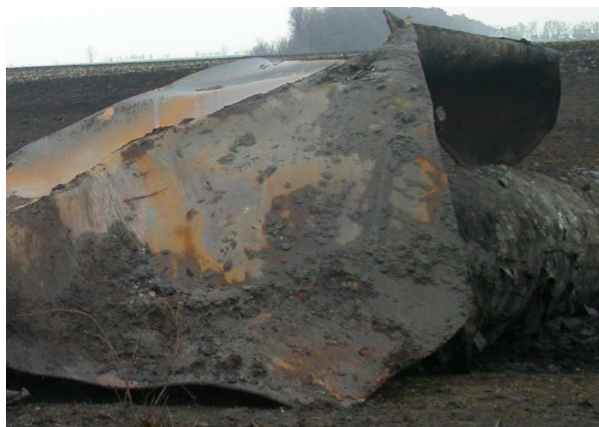
Рисунок 2 – Характерний приклад катастрофічного руйнування труби діаметром 1420 мм магістрального газопроводу “Уренгой–Помари–Ужгород” (2007 р. біля КС “Іллінці”)
