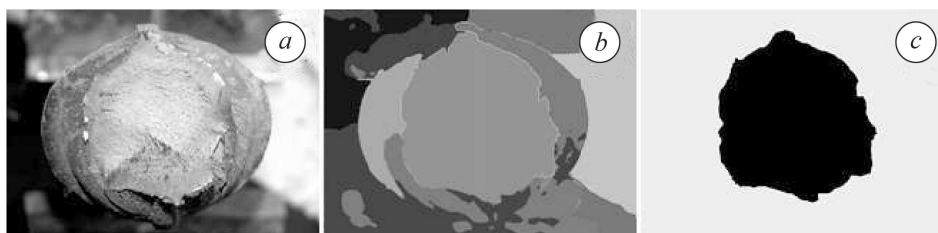
Рис. 3. Зображення зламу арматурного стрижня: a – вихідне, b – після виокремлення поверхонь з розбиттям на класи, c – після бінарзації із замиканням.
