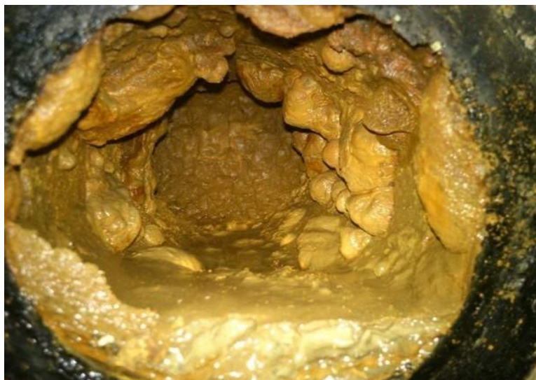
Рис. 3. Фрагмент сталевого водопроводу внутрішня поверхня якого деформована внаслідок процесів корозії та біологічного заростання [8]
