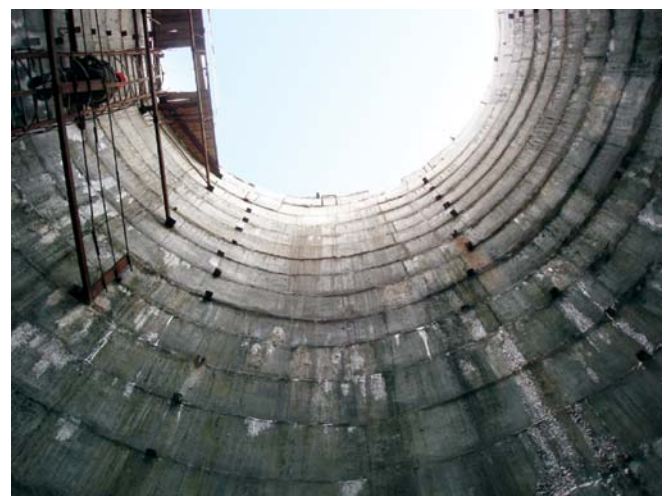
Рис. 6. Оглядова шахта на головному дублюючому каналізаційному тунелі
