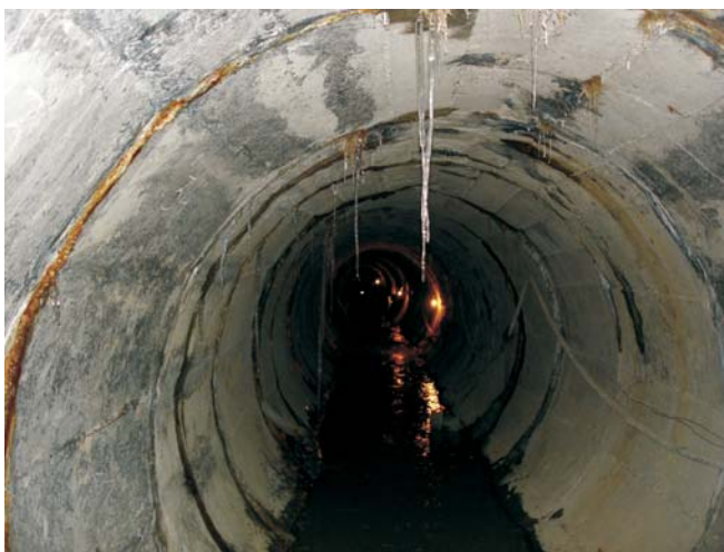
Рис. 5. Стан конструкцій головного дублюючого каналізаційного тунелю
