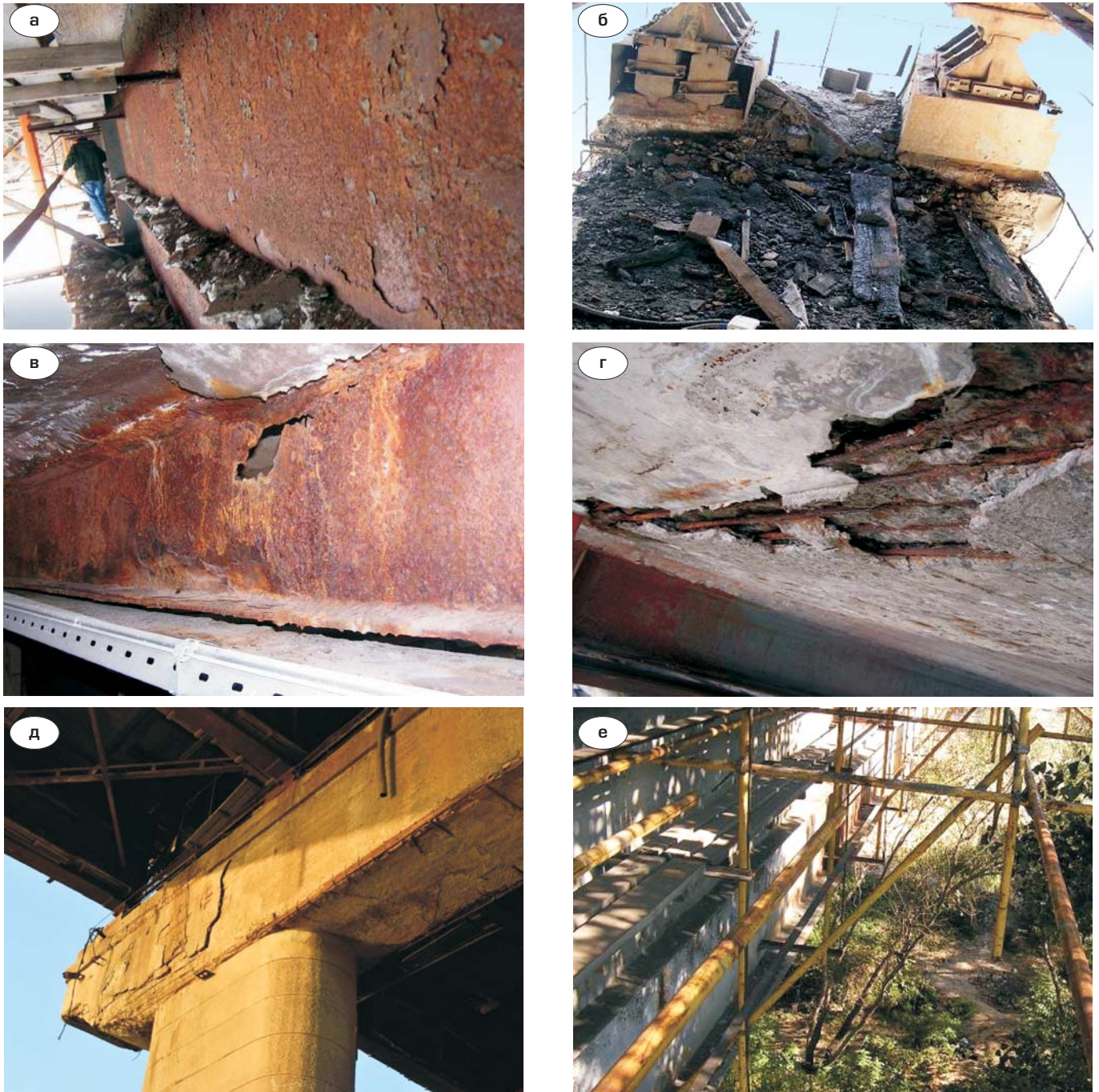
Рис. 6. Дефекти конструкцій моста ім. Є.О. Патона:
