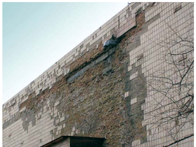
Рис. 3. Руйнування кладки стіни фасаду по осях 10–1 у місці розташування водовипускних пристроїв
