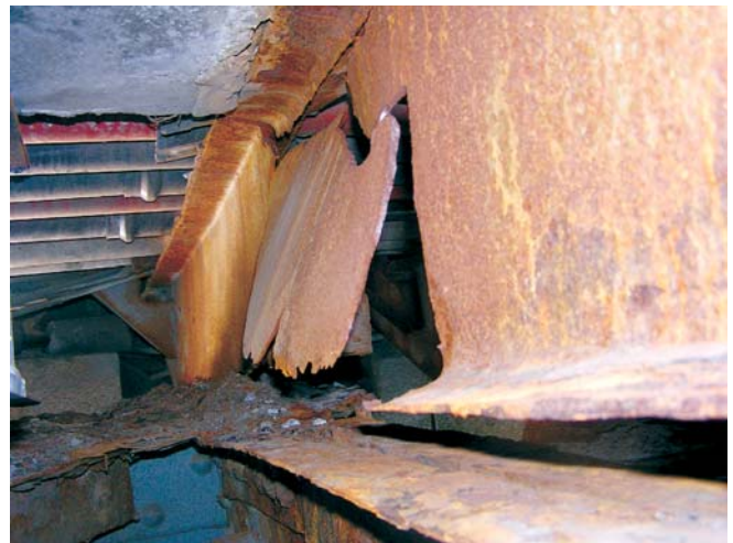
Рис. 3. Руйнування поперечної балки на опорі № 1
