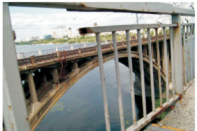
Рис. 12. Відсутнє заповнення перил у місці розташування деформаційного шва
