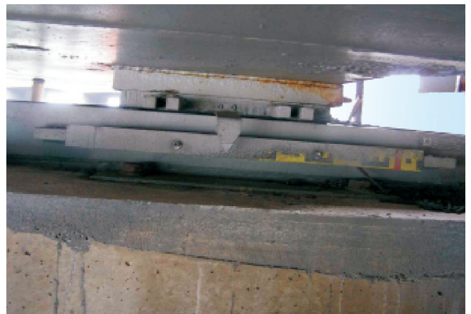
Рис. 8. Поверхнева корозія опорних плит опорної частини
