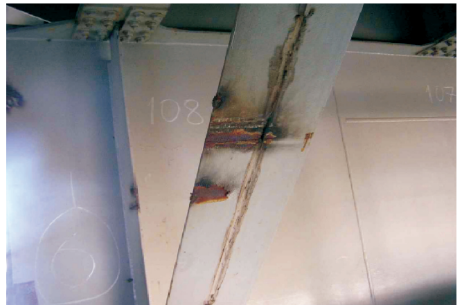
Рис. 7. Залишки монтажних елементів, антикорозійне покриття зруйноване, поверхнева корозія металу
