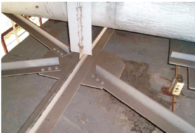
Рис. 6. Відсутній (демонтований) елемент горизонтальних в'язей по нижніх поясах прогонової будови
