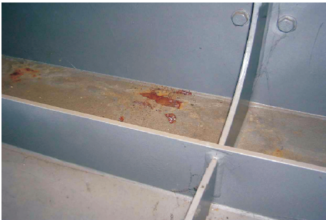
Рис. 5. Корозія нижнього поясу балки
