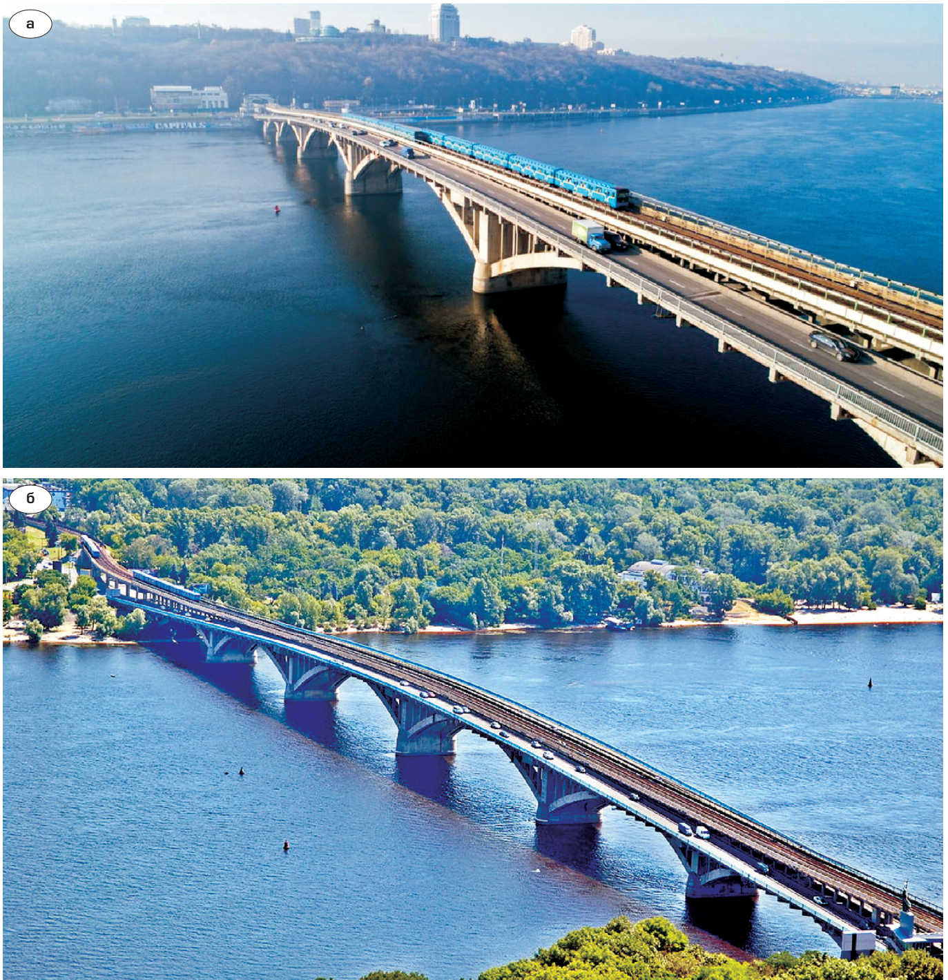
Рис. 1. Загальний вигляд моста метро з низового (а) та з верхового (б) боків
