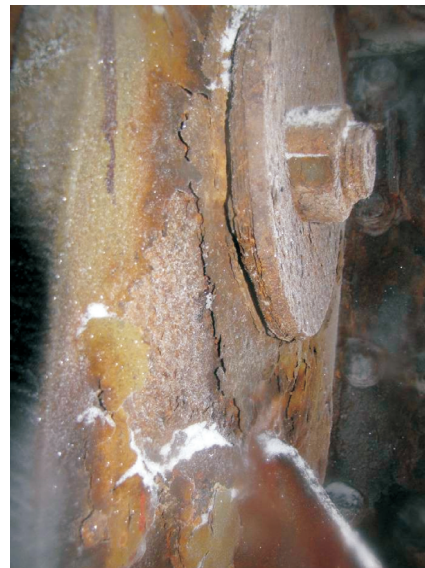
Рис. 5. Корозія конструкцій шарніра
