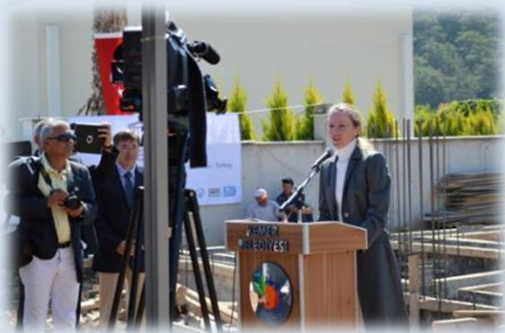
Виступ Ульріке Герін, Секретаря Конвенції та Консультативного органу на церемонії закладки фундаменту будівлі Наукового центру підводної археології в Кемері.
