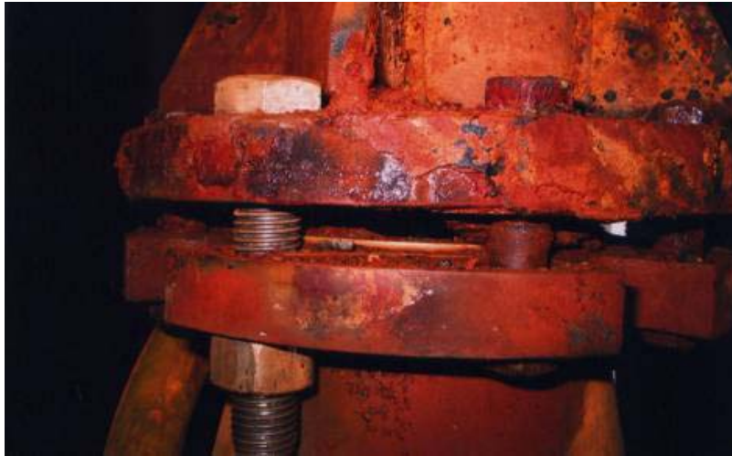
Рис. 10. Погружной насосный агрегат фирмы «Pleuger» PN 8220+N110- 600-2 (63-380) после аварии 19.02.2007 г. и подъема: вид на соединительный фланец водоподъемной колонны и фланец насоса фирмы «Pleuger». Прослеживается раскрытие стыка и деформация болтов, выдавливание межфланцевой прокладки и, как следствие, полная потеря подачи насоса. Аварийная ситуация связана с высокой вибрацией, неуравновешенностью ротора, неперпендикулярностью посадочных плоскостей фланцев. Обращает внимание разнокалиберность стяжных шпилек, что говорит о неоднократном подъеме машины
