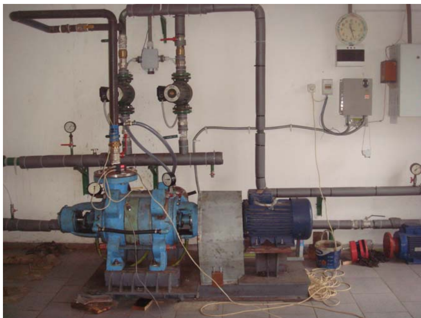
Рис. 3. Агрегат термодинамический трехступенчатый на одной из тепловых станций Украины. Вид сбоку на установку и частотный преобразователь ATV-21
