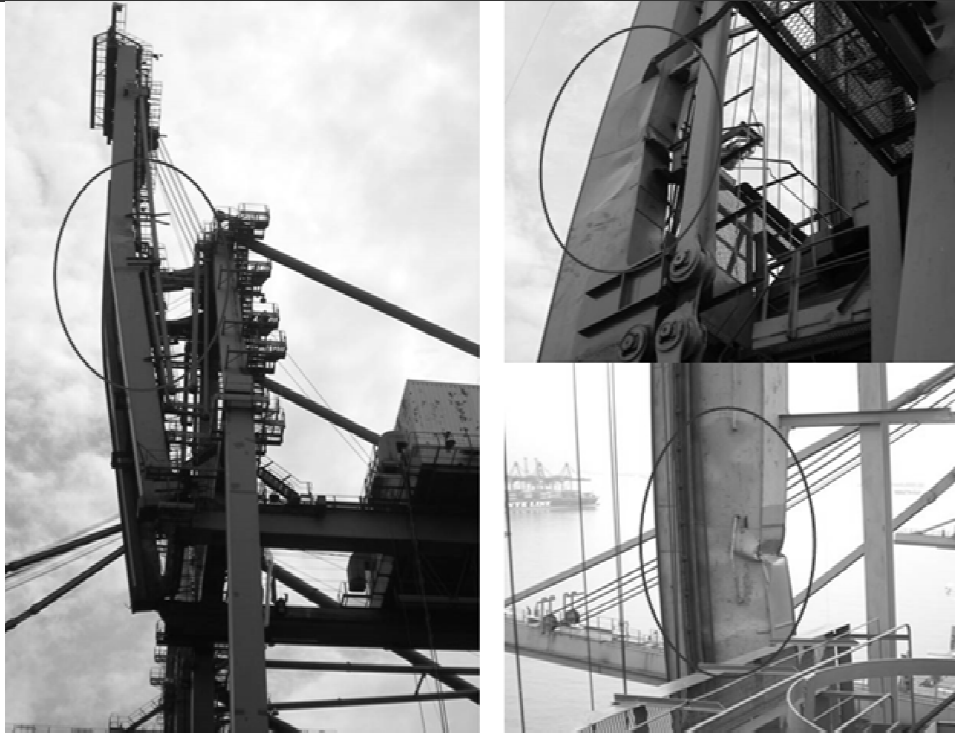
Фото 2 – Деформации морской консоли в результате нерабочего состояния конечного выключателя механизма подъема стрелы
