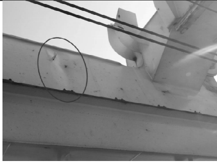
а) деформация внутренней стенки правой балки морской консоли
