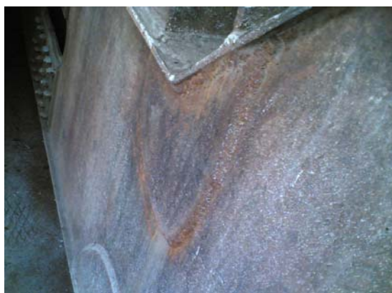
Рисунок 7 Місце пошкодження головної балки
