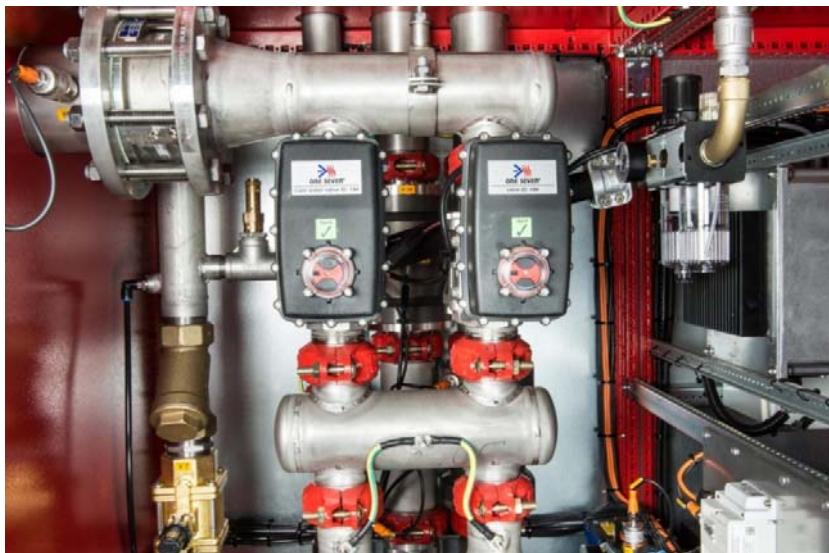
Рис. 2. Стаціонарна установка пожежогасіння One seven
