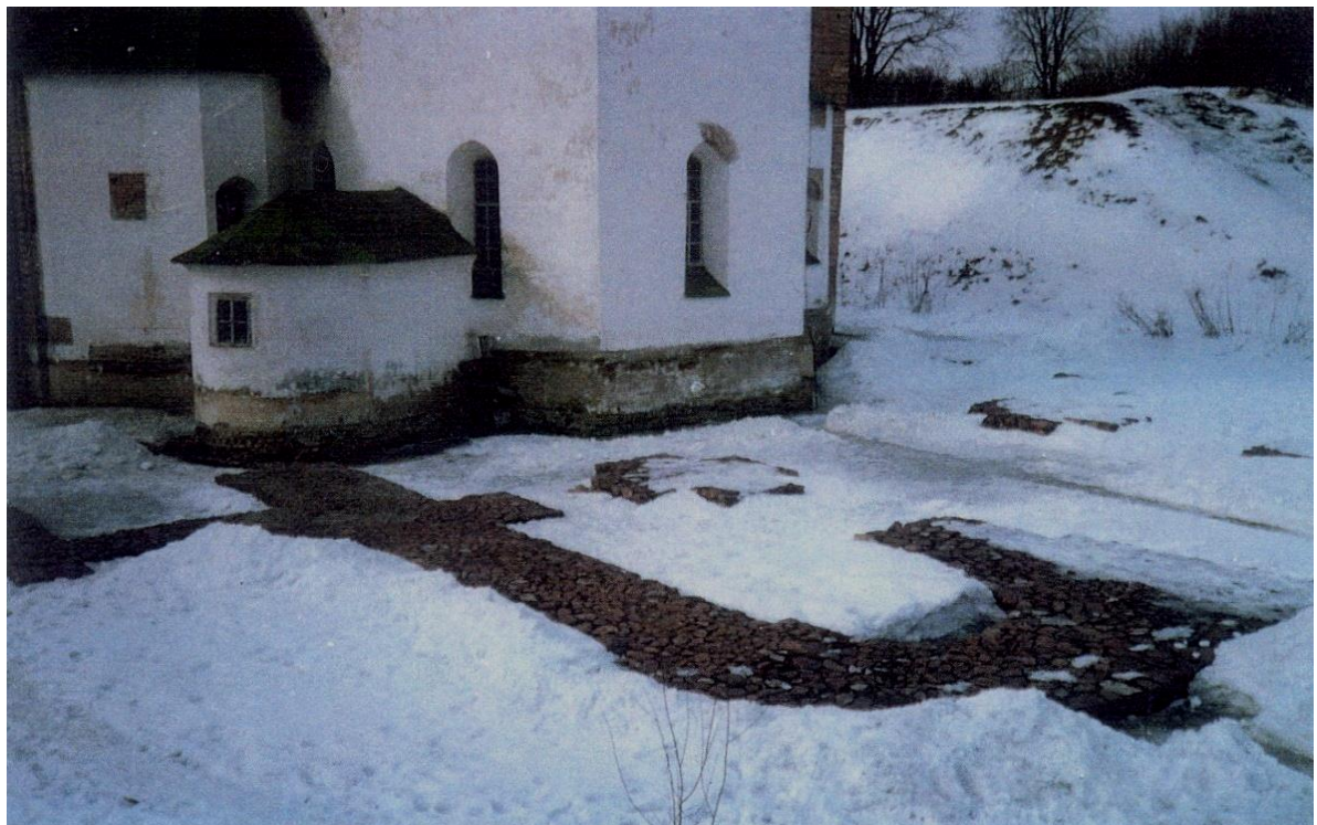
Рис. 3. Зволожені стіни апсид церкви Спаса на Берестовому
