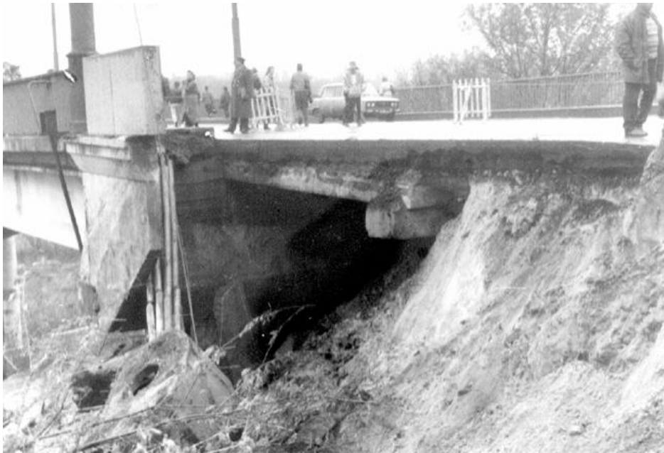
Рис.2. Обвалення ґрунту із руйнуванням комунікацій біля опори №6 Олексіївського віадукі в 1992 році.
