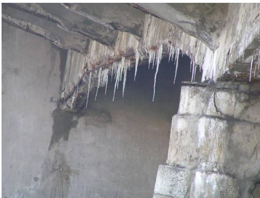
Рис.1. Фільтрація води по консолі тротуару й фасадній балці Купецького мосту м. Харкова
