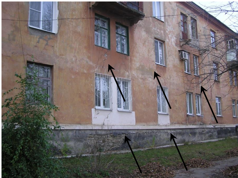
Рис.1. Общий вид на фасад жилого дома по ул. Макарова, д.79 в г. Макеевке. Выпучивание из вертикальной плоскости фундамента из бутовой кладки с образованием горизонтальной трещины раскрытием до 30мм. Наклонные трещины раскрытием до 1мм в наружных стенах.
