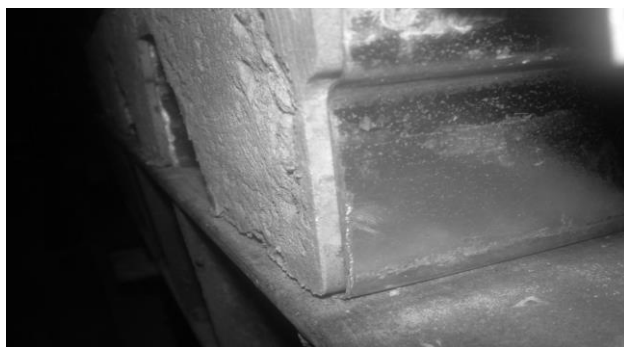
рис. 4 – Зміщення бетонного блоку відносно профнастилу при відсутності ви штамповок
