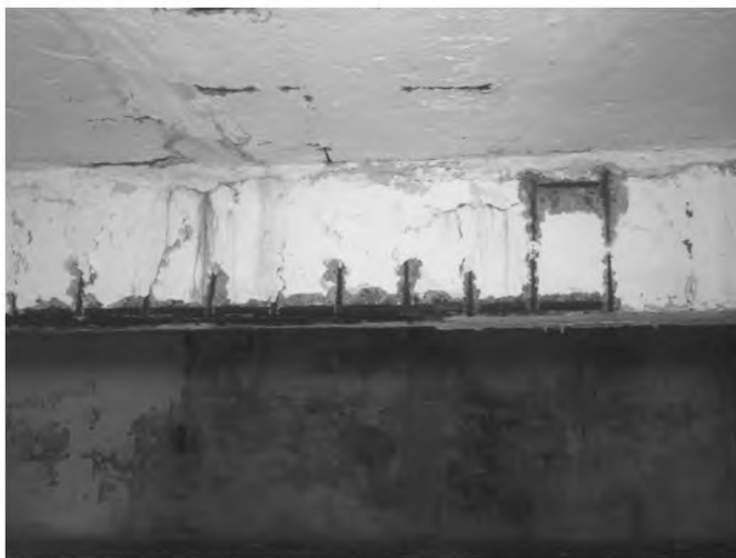
Рис. 1. Пошкодження центрального несучого ригеля.
