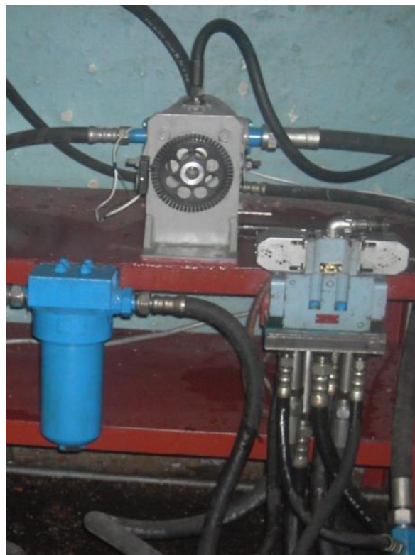
Рис. 7. Узел измерения расхода и направления потока рабочей жидкости
