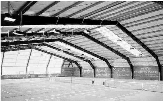
Мал.2 Металеві конструкції
