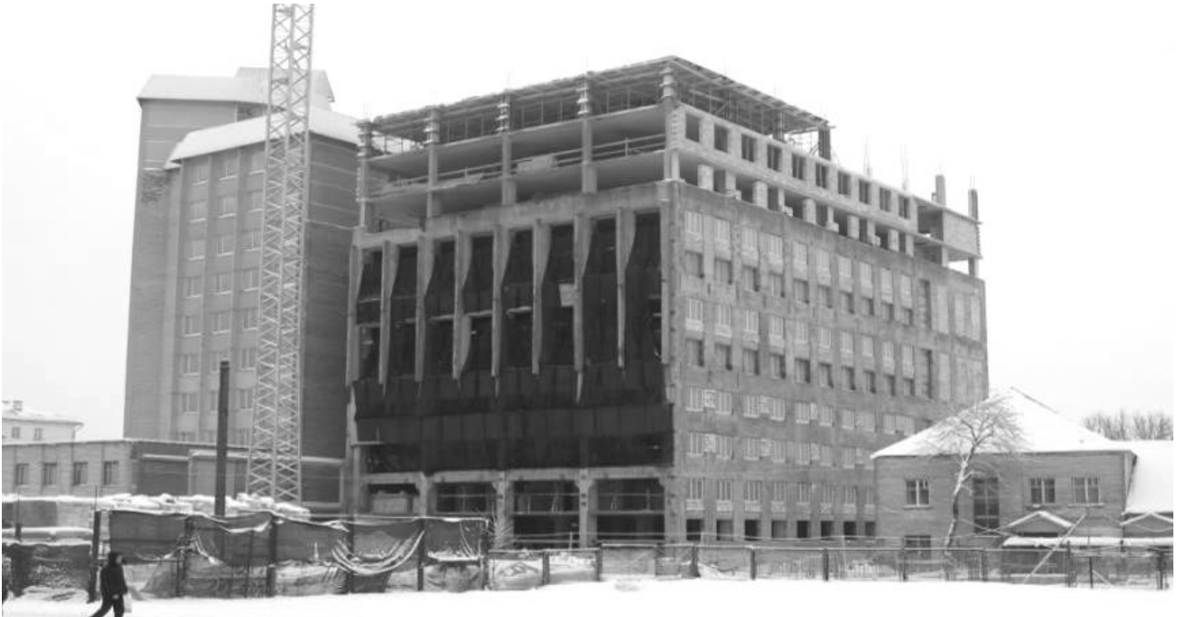
Рис.8. Реконструкція незавершеного будівництва виробничого корпусу під адміністративну будівлю з приміщеннями громадського призначення та вбудованим гаражом-стоянкою та багаторівневою гостьовою автостоянкою з об'єктами обслуговування (вул. Зм. Бядулі, м.Мінськ, Білорусь).
