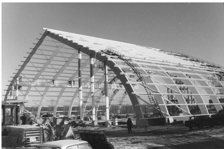
Рис. 9 Покриття універсального спортивного стадіону. Двохшарнірні арки з клеєної деревини прольотом 100 м м. Ванкувер. Канада, 2008 р.
