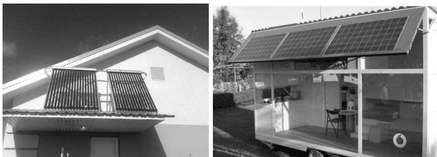
Рис. 6,7. Гелиоустановки на конструкциях козырьков.
