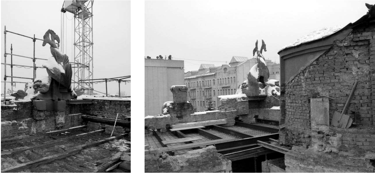
Рис. 1 Будинок з химерами по вул. Банкова 10, стан перекриття даху до- і в процесі реставрації.
