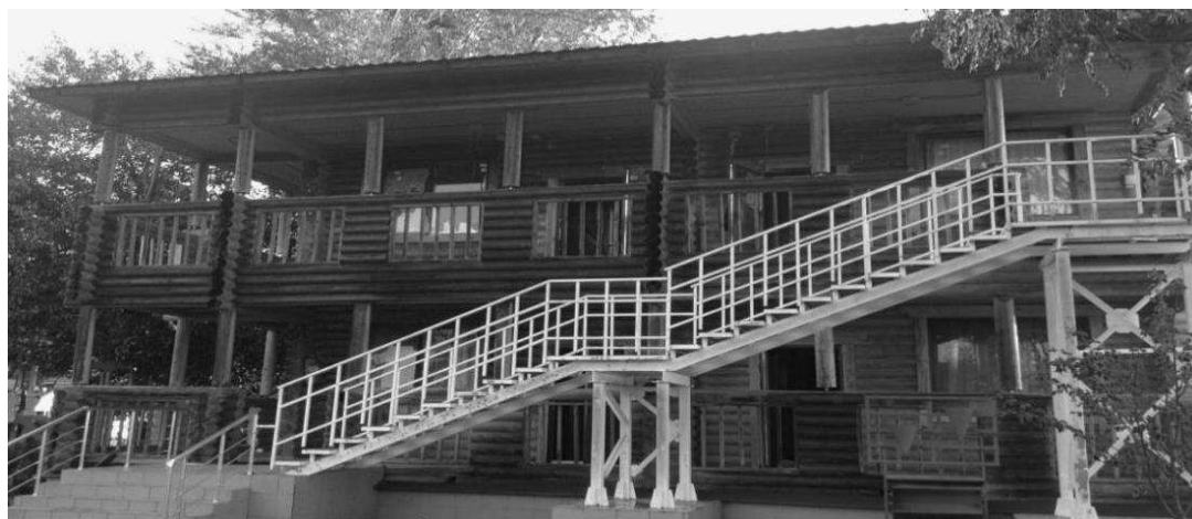
Рис. 2. Загальний вигляд термічних пошкоджень будівельних конструкцій корпусу №6. Вид з південної сторони
