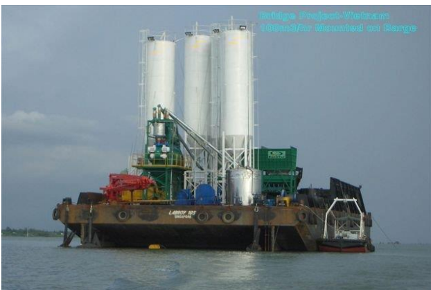
Рис. 7. Бетонозмішувальний завод фірми EUROTEC ASIA PACIFIC
