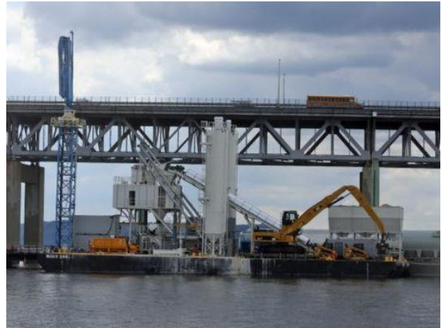
Рис. 8. Бетонозмішувальний завод фірми Batchtec
