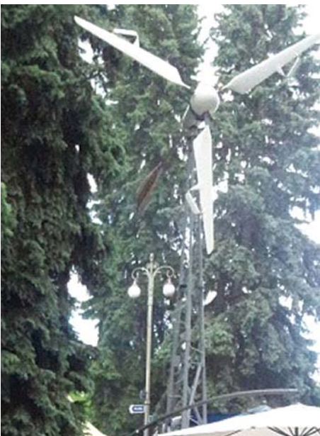
Рис. 12 – Обладнання для використання енергії вітру
