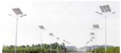
Рис. 14 – Автономне освітлення вулиць, доріг і діляниць
