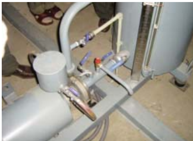
Рис. 6 – Насос, трубопроводи та запірно-регулювальна арматура для перекачування сумішей лінії ТЕК-1БД
