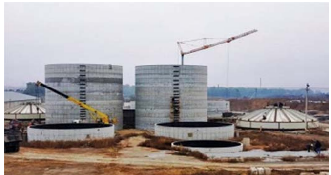
Рис. 6 – Біогазовий комплекс ТОВ «Wolf System», який будується в аграрній компанії «Екопрод» (Донецька обл.)
