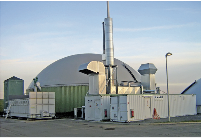
Рис. 3 – Загальний вигляд біогазової установки біоенергетичного селища Юнде
