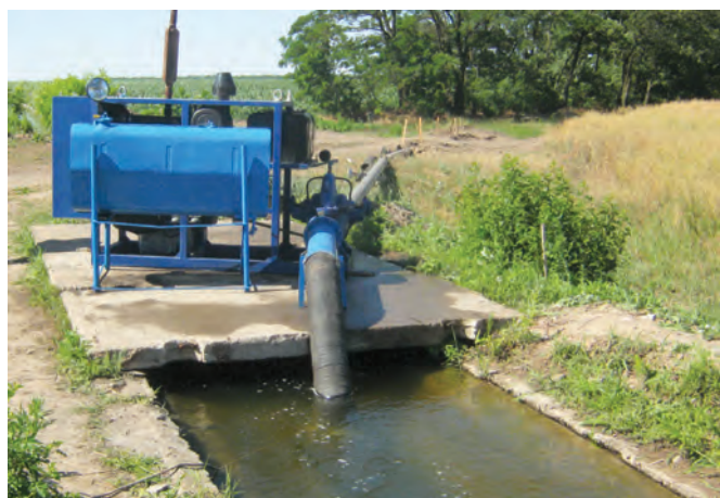
Рис. 3 – Пересувна насосна станція з дизельним приводом АНД 300-60 (ТОВ «ТД-Н.К. Енергомаш», м. Н. Каховка)
