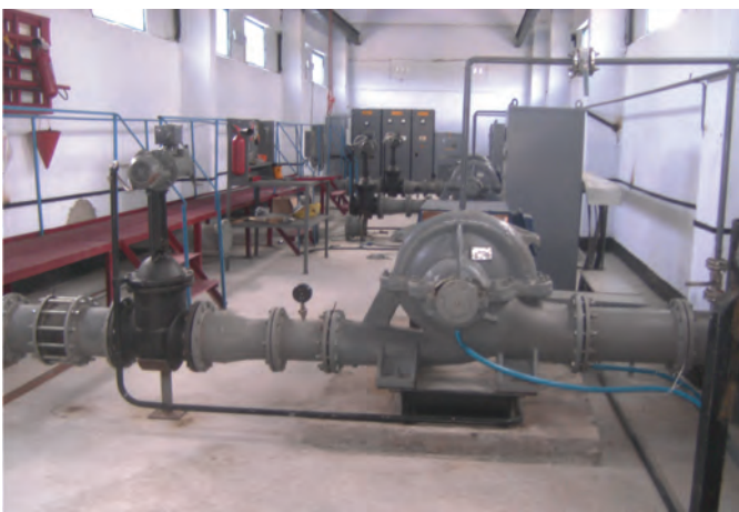
Рис. 1 – Електрична насосна станція стаціонарного розміщення
